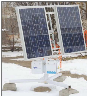
Fig. 1. Instalație fotovoltaică cu orientare automată la soare pentru alimentarea cu energie electrică a posturilor antigrindină și pomparea apei
