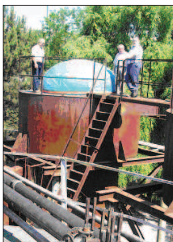
Рис.1. Общий вид пилотного биогазового реактора на винзаводе «Бардар» для утилизации винодельческих отходов
